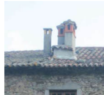
Souches modernes disparates, plusieurs petits conduits sur la base d'un seul ancien
