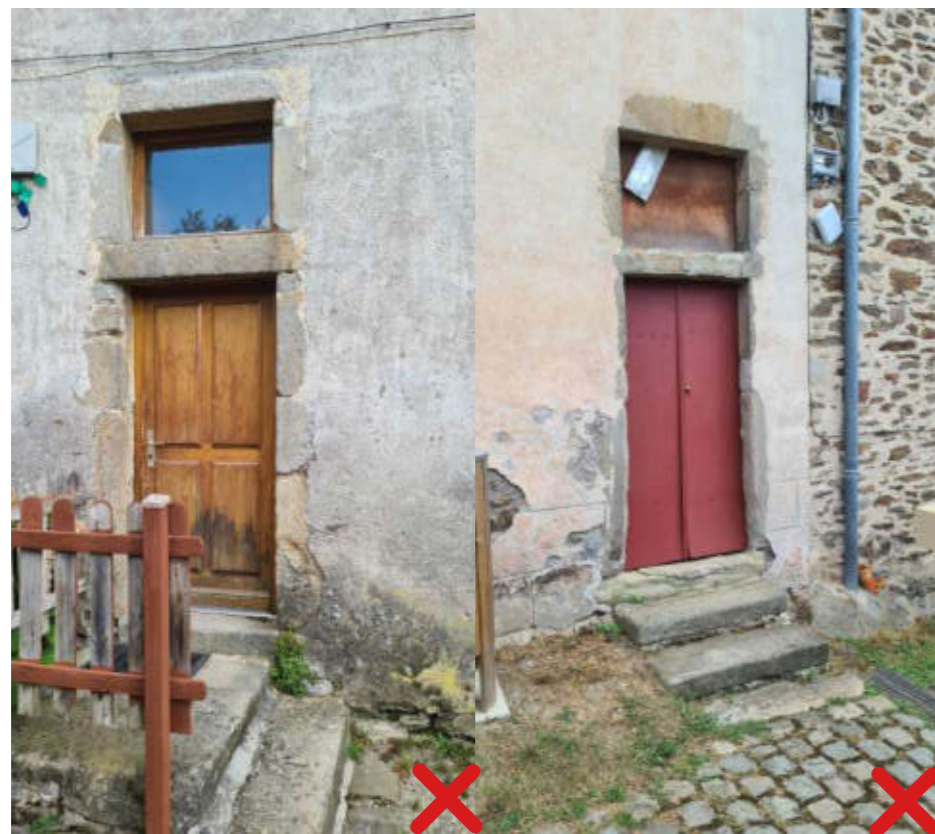
Portes des parcelles adjacentes aux tours de Porte de la chartreuse, sur cour des Obédiences, et leur grande impostes créées par ajout de meneaux pierre.
