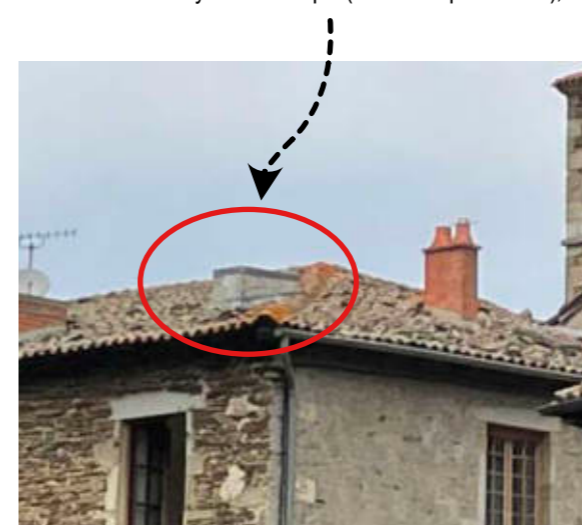
Souches de cheminée, vestige d'une ancienne (à gauche) et souche moderne (à droite), la souche ancienne a été enduite et bouchée (zinc) depuis 2015 Source : Croisée d'archi, 2025
