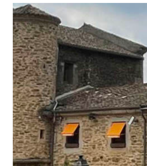
Vue actuelle, toiture bâtiment Ouest façade principale de la Chartreuse, toiture restaurant « le Prieuré » _ Source : Croisée d'archi
