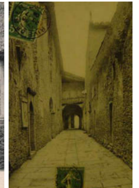
Murs du Grand passage décrépis
