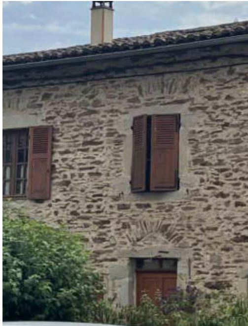
Porte moderne à deux panneaux sur modèle de portes anciennes => imposte vitrée de faible hauteur divisée suivant partition des panneaux de porte => ok Traverse bois formant larmier => ok.
